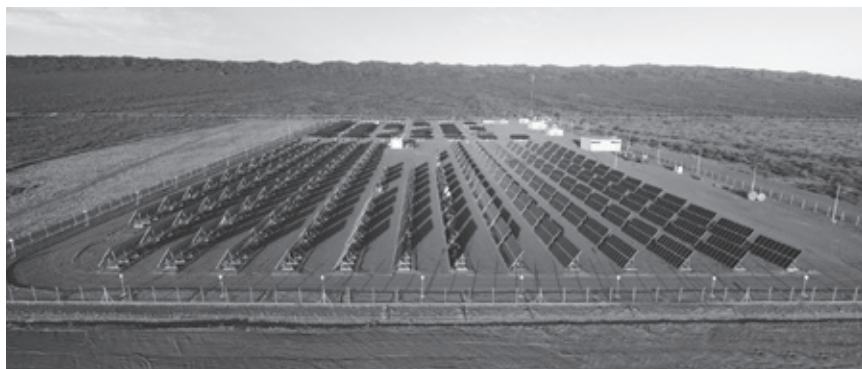
Primera planta fotovoltaica del tipo "Huerta Solar" que se conecta a la red en todo Sudamérica. 1,2 MWp
